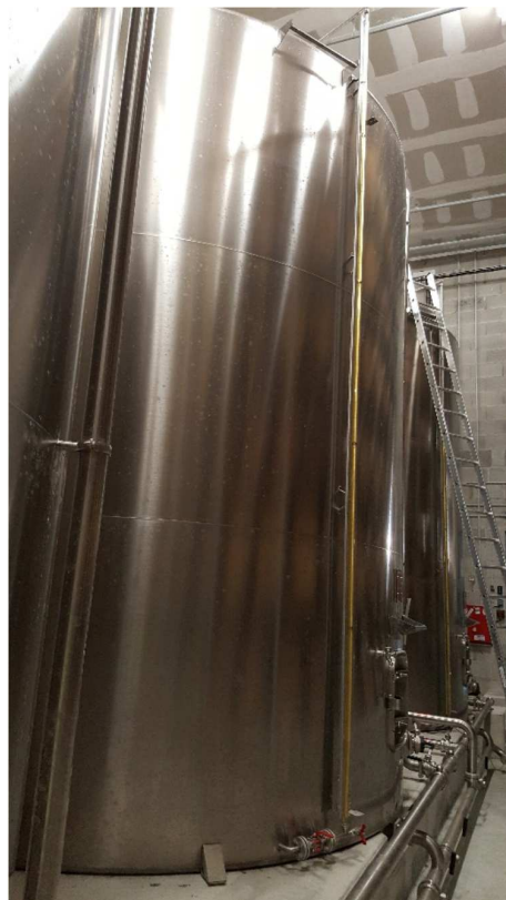
Photo 7: Cuves inox utilisées pour le stockage des réserves climatiques et préparation de sortie
